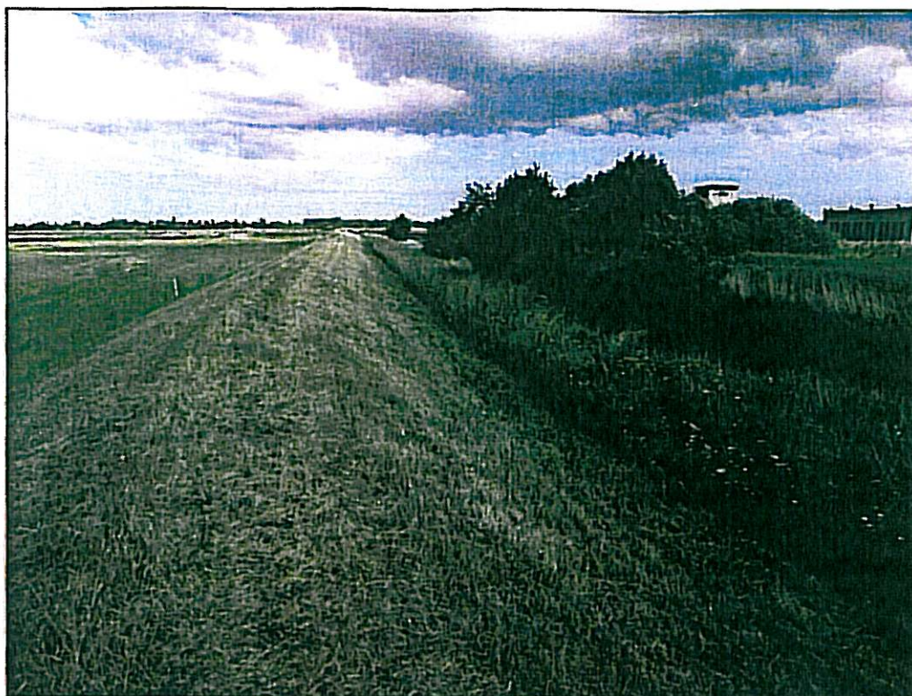
Fot. 1. Wal przeciwpowodziowy na Rzece Reda – początkowy odcinek planowanej inwestycji w km. 1+612, na przeciwległym brzegu rzeki widoczna stacja pomp „Rekowo”.
